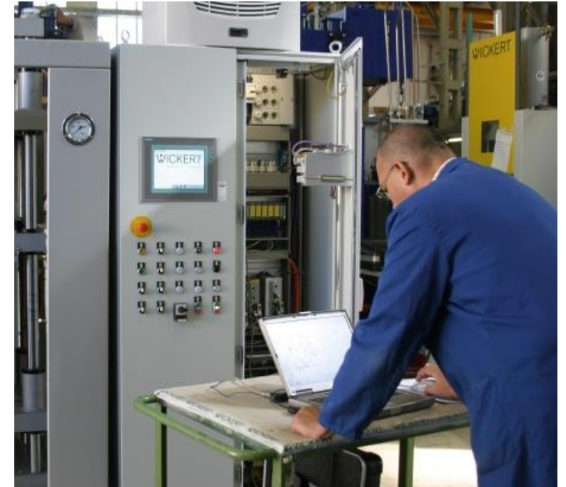
Elektrische Inbetriebnahme: Fein-Tuning
