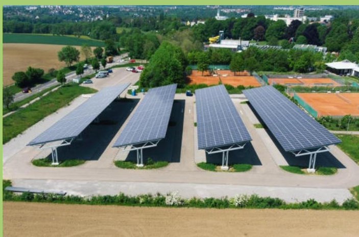
Abb. 1: Solarüberdachung von Parkplätzen
